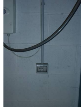
Particolare impianto elettrico
