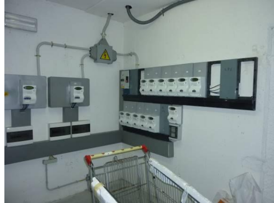
Piano interrato – locale contatori
