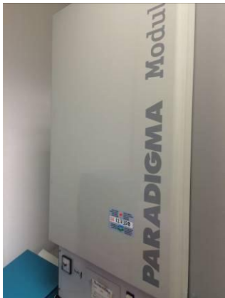
Caldaietta all'interno del ripostiglio
