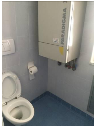
Caldaietta autonoma nel wc
