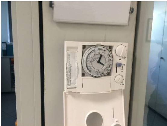
Particolare regolazione riscaldamento
